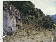
小和清水町 法面崩壊事故 (平成21年9月発生)
