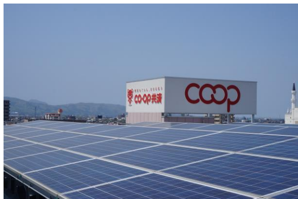
自社施設屋上への太陽光発電設備の導入
